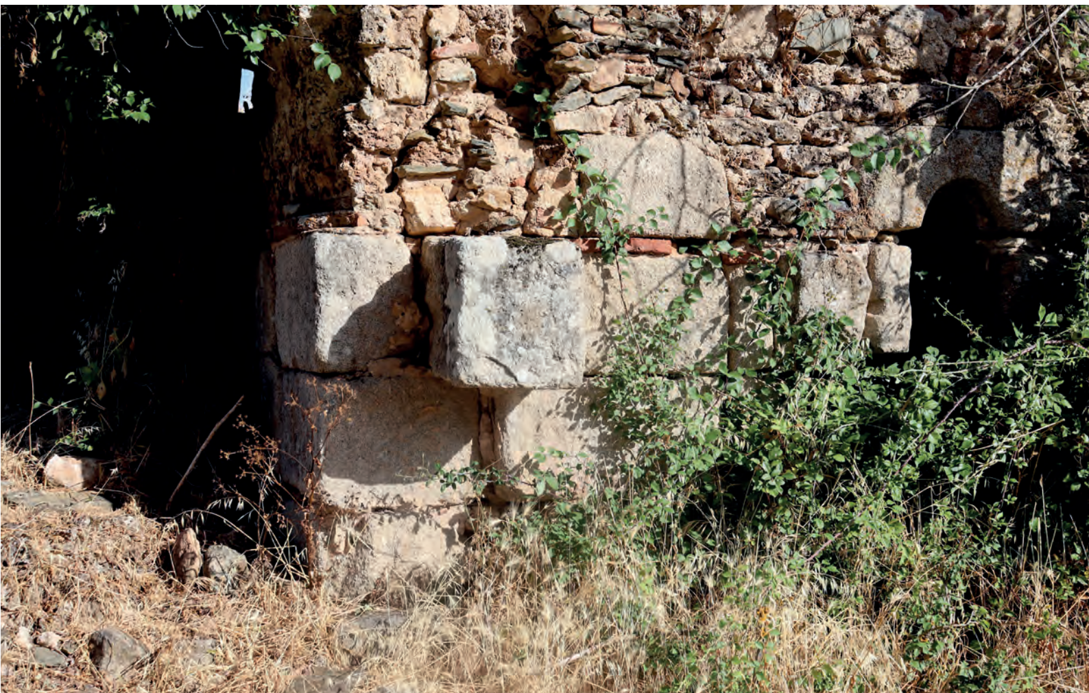
FIG. 23. Pormenor de los sillares de granito de unión de edificios en la cabecera
