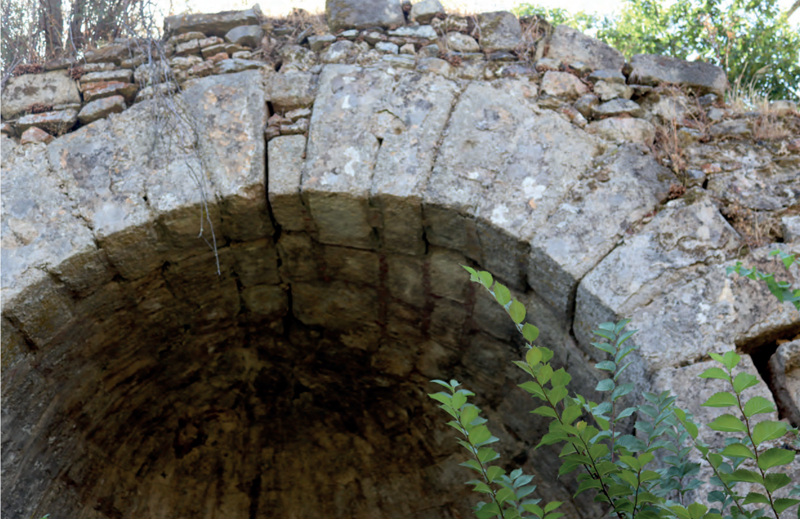
FIG. 12. Vista del arco de la bóveda con la clave posteriormente intervenida
