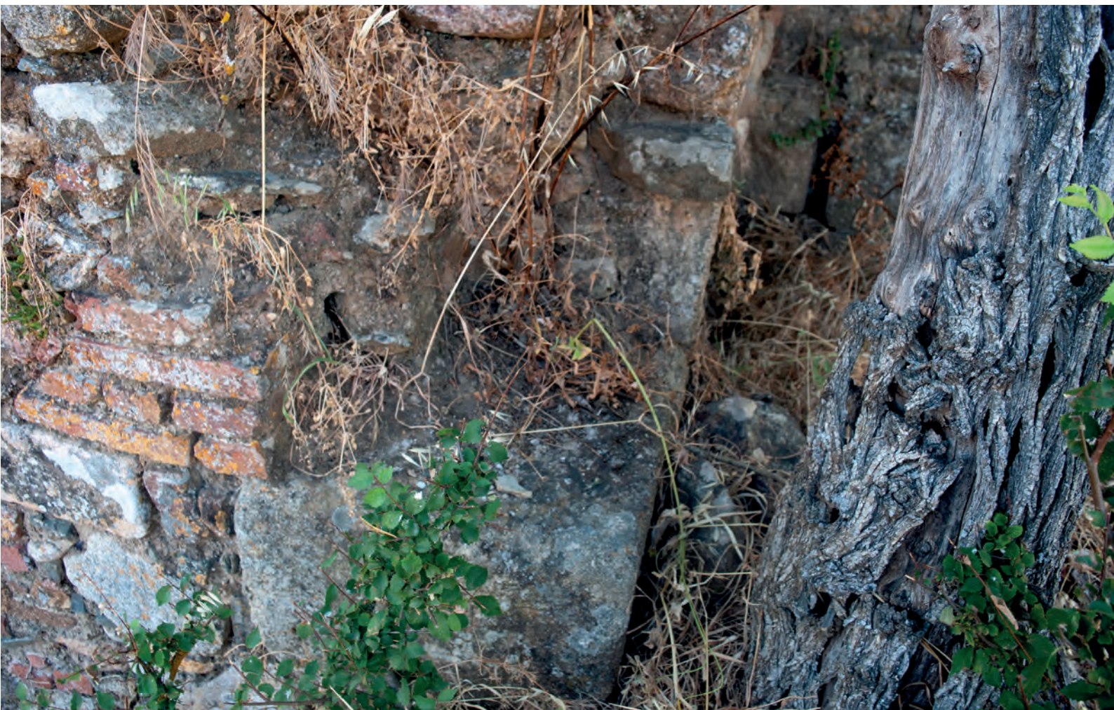
FIG. 31. Detalle del zócalo de granito como base de la mampostería superior de los muros
