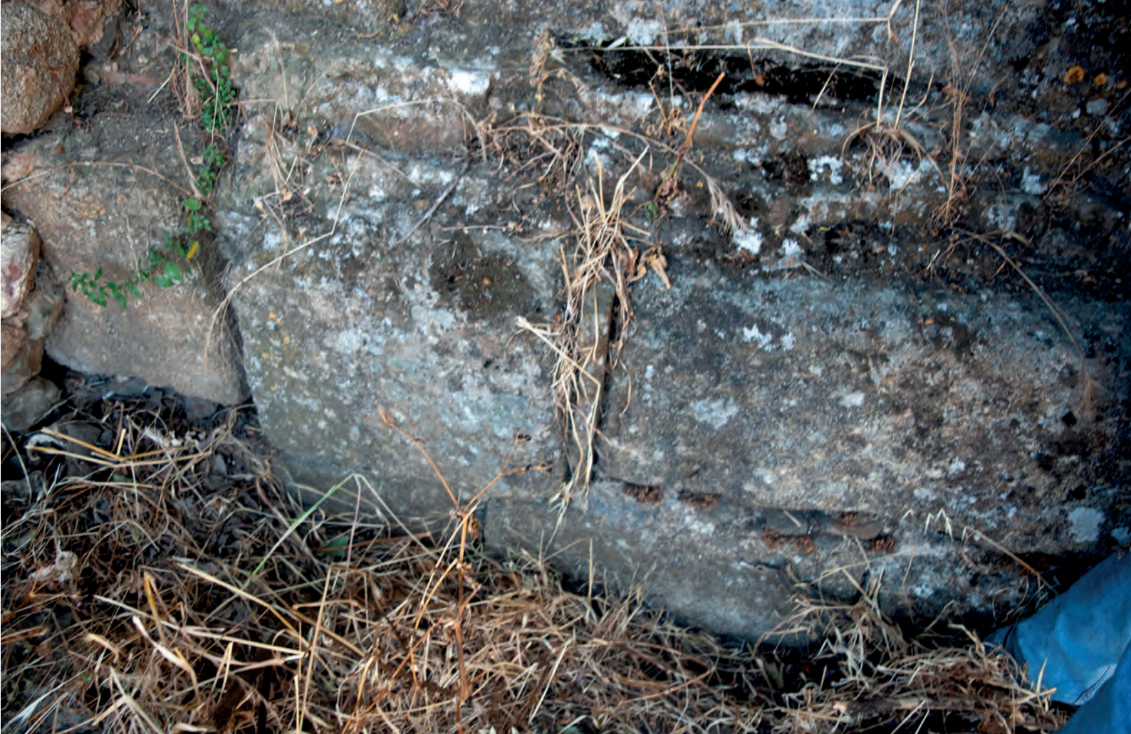
FIG. 32. Vista en Pormenor de la unión de los sillares de granito en el zócalo del edificio
