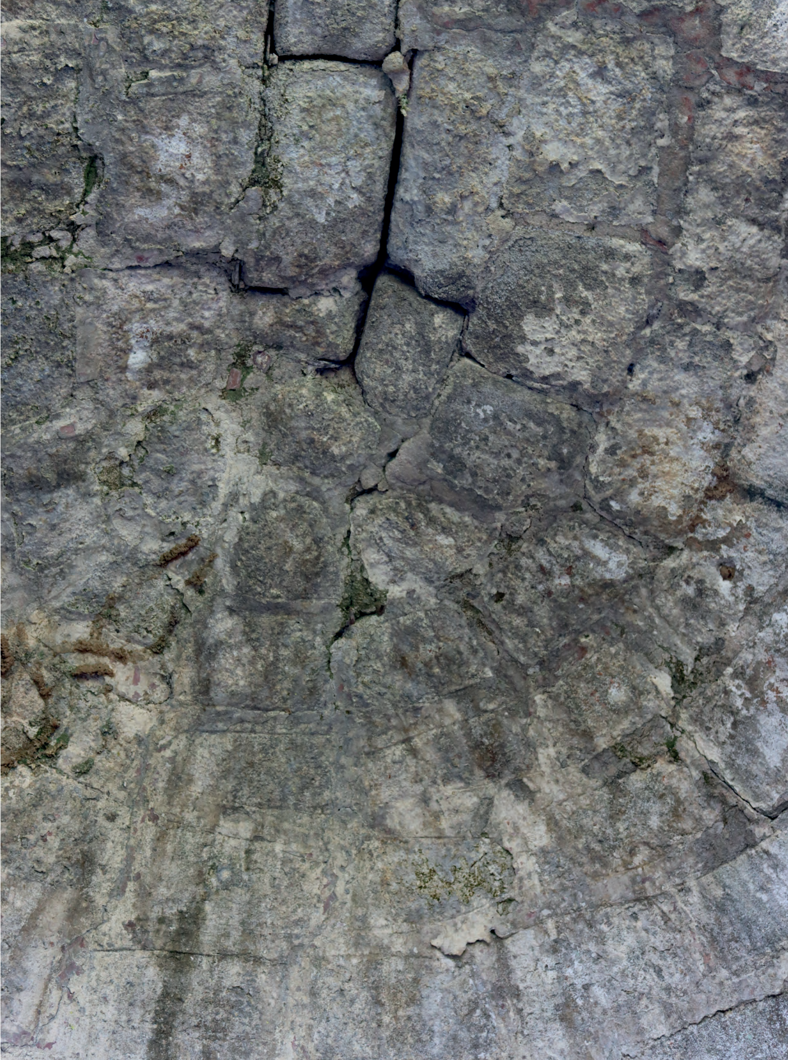
FIG. 8. Pormenor de los efectos del avance de los daños en la estructura granítica de la bóveda
