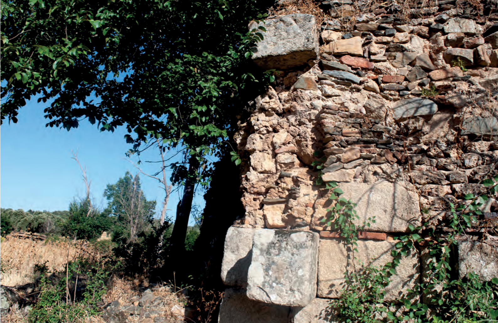
FIG. 22. Detalle de la construcción del muro de sillares de granito de la cabecera con arranque de los arcos de los edificios adosados
