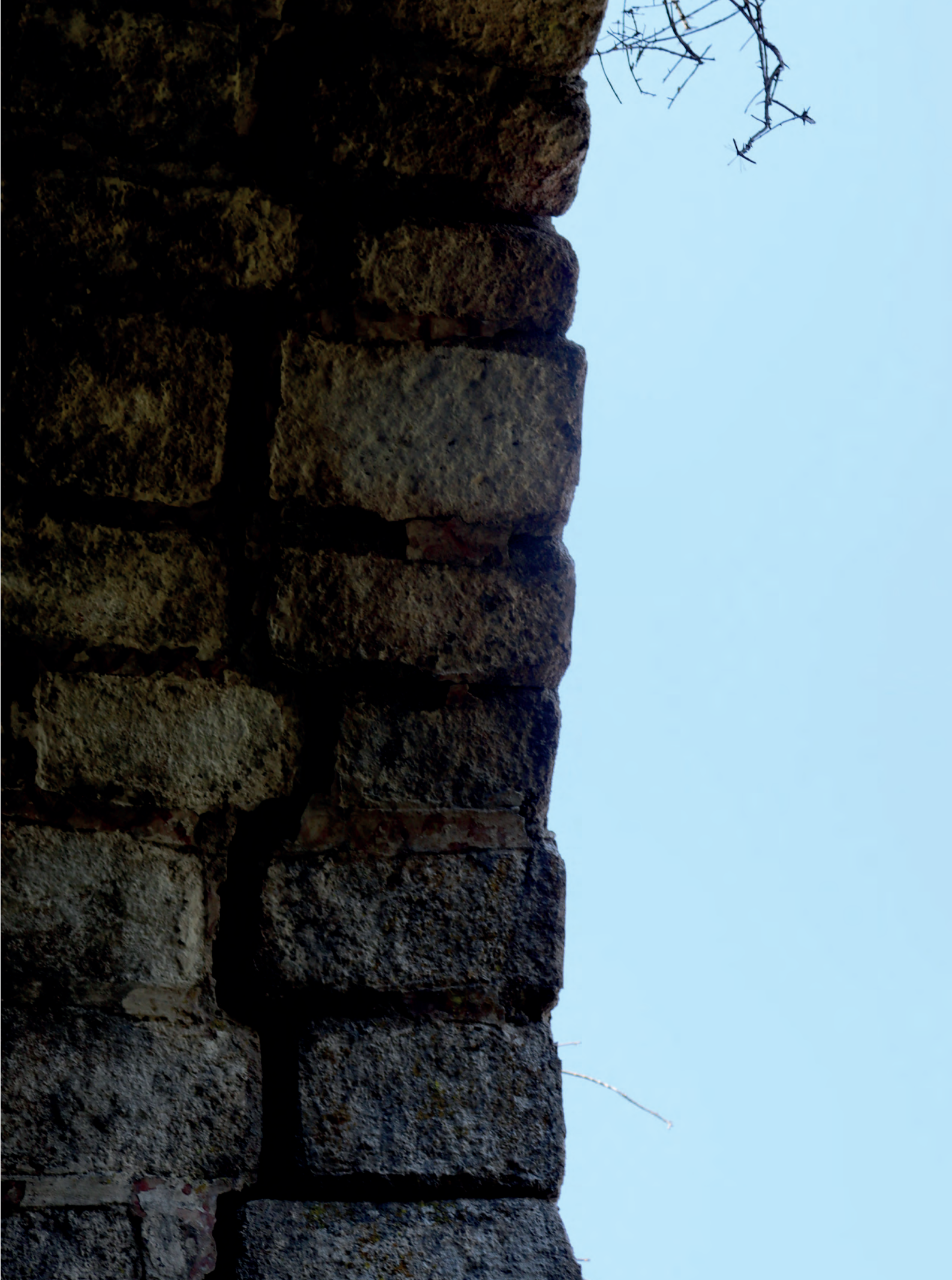
FIG. 11. Detalle del desarrollo y continuación de grieta en la bóveda
