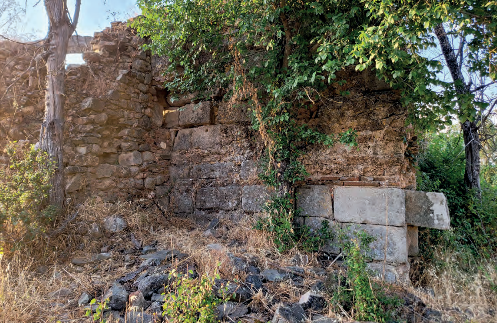
FIG. 30. Vista general de la superposición del zócalo de granito con la obra de mampostería integrada
