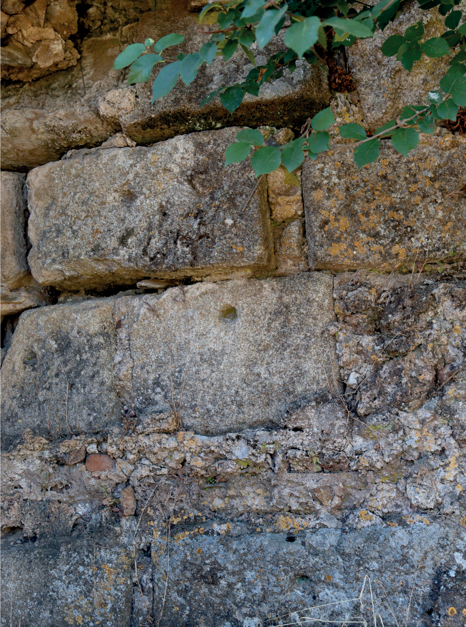
FIG. 35. Pormenor de la integración de los sillares de granito con la obra de mampostería posterior
