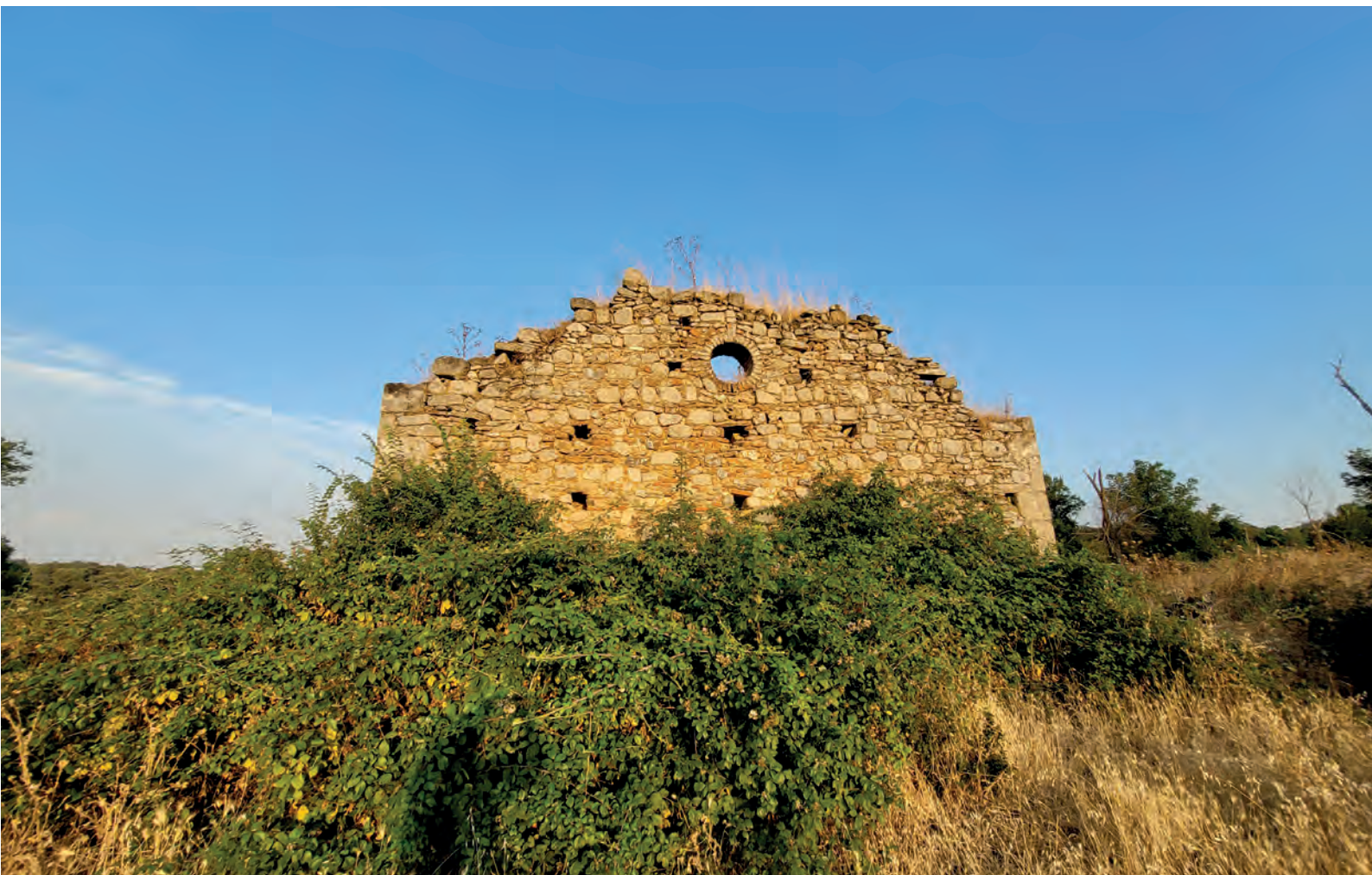
FIG. 2. Vista de la zona de la pared trasera de mampostería con vano circular
