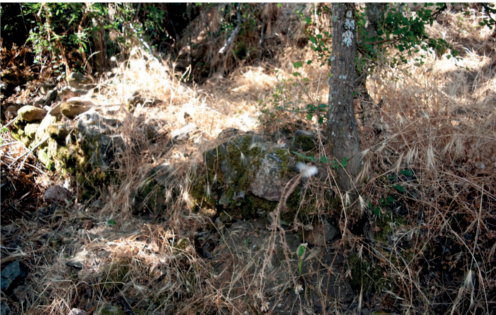
FIG. 59. Pormenor de los restos de zócalo de granito en los edificios próximos
