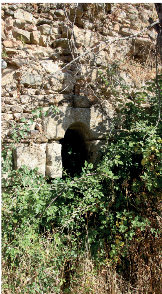
FIG. 99. Detalle del muro posterior con ventana de falso arco en San Miguel de los Fresnos.
